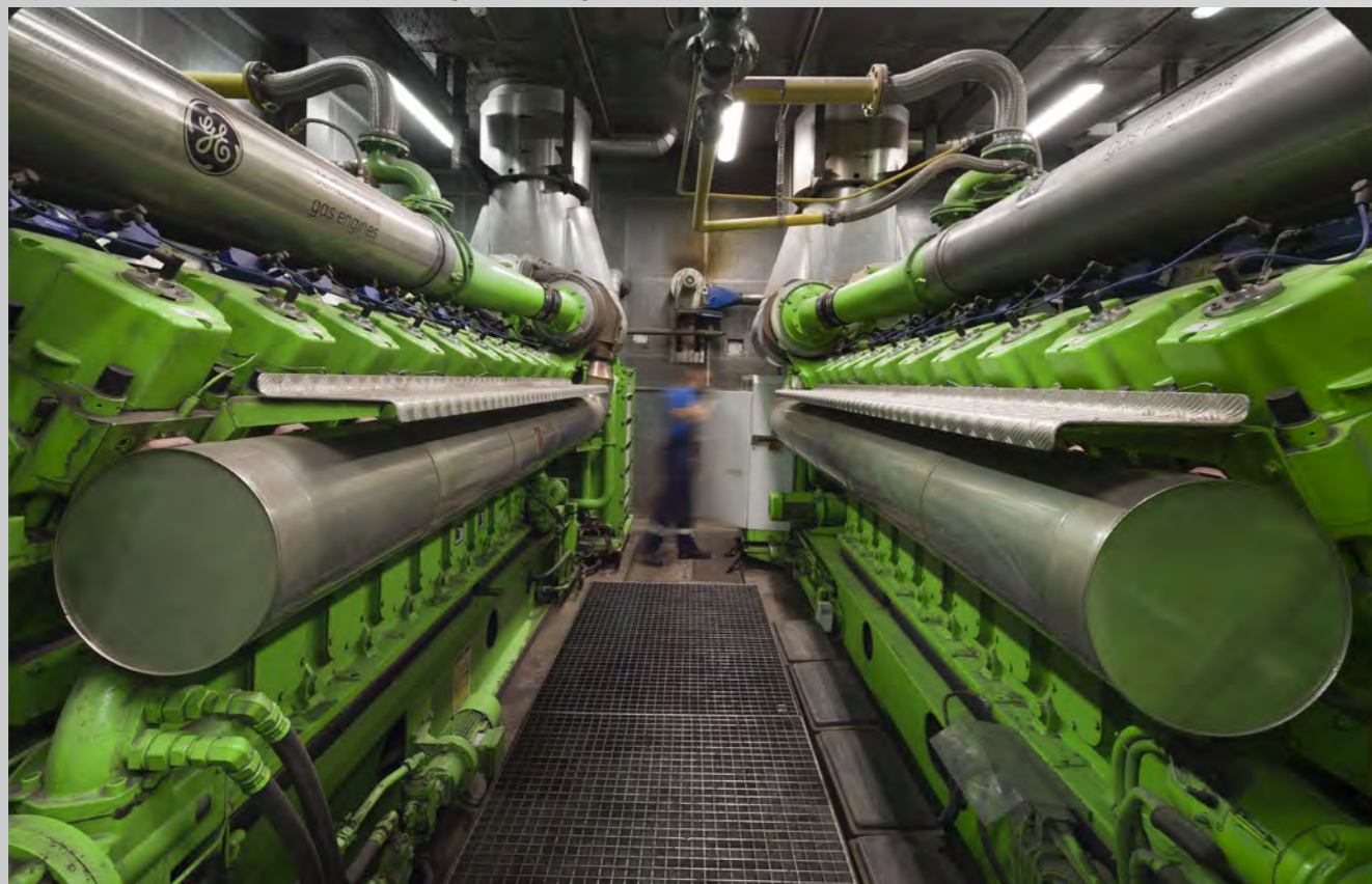
Soproizvodnja toplote in elektrike za potrebe gospodarskega območja Ravne na Koroškem
