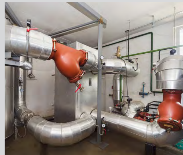
Toplotni izmenjevalci izkoriščanja vira (zajem odpadne toplote)
